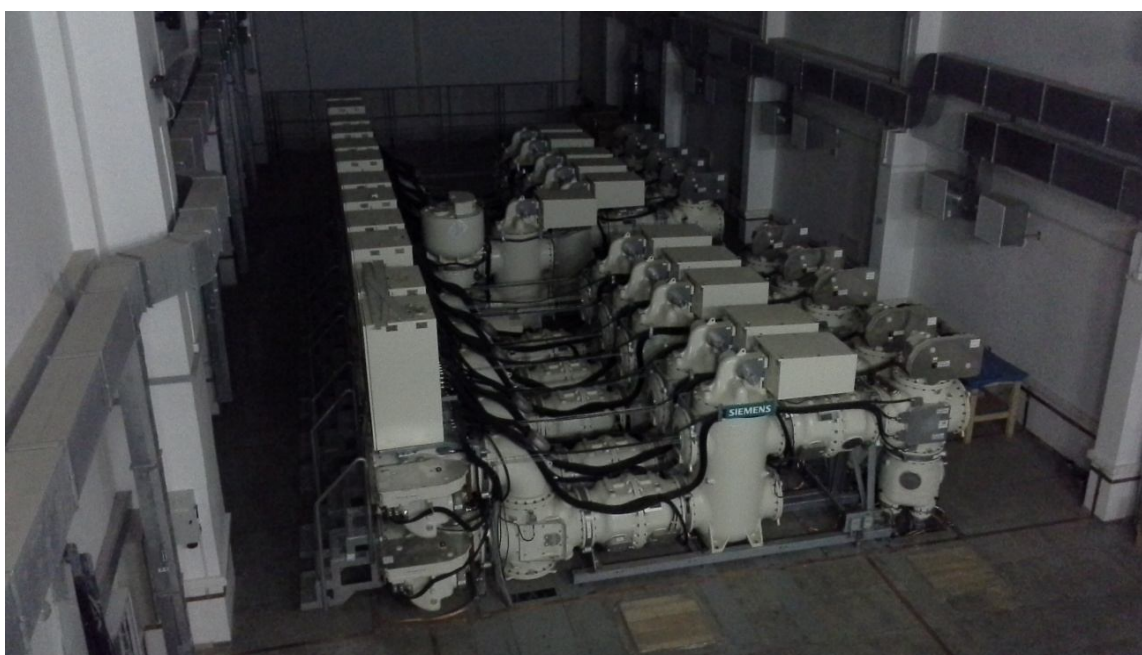
Рис. 6.3 Помещение КРУЭ 110 кВ
