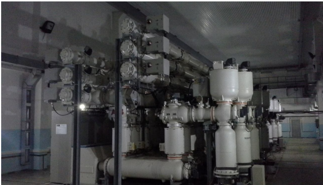
Рис. 6.2 Помещение КРУЭ 220 кВ
