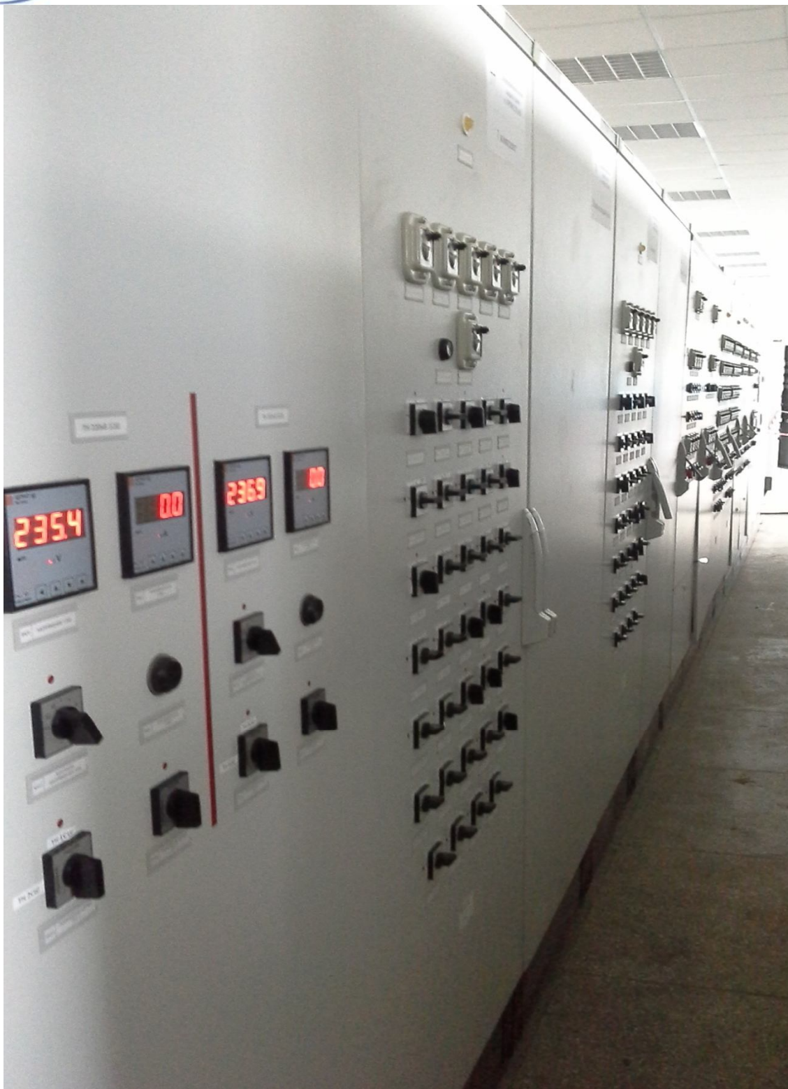
Рис. 6.7. Помещение релейного щита управления.
