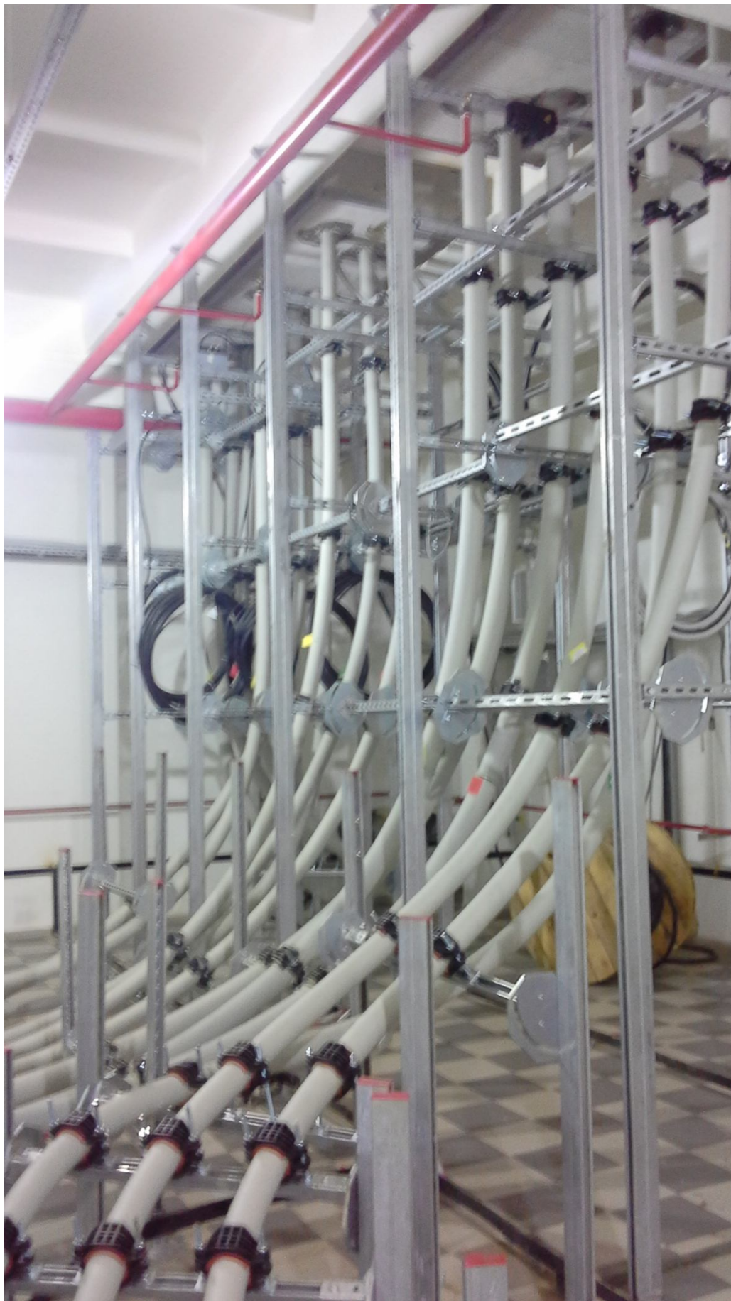
Рис. 6.6. Помещение кабельного этажа
