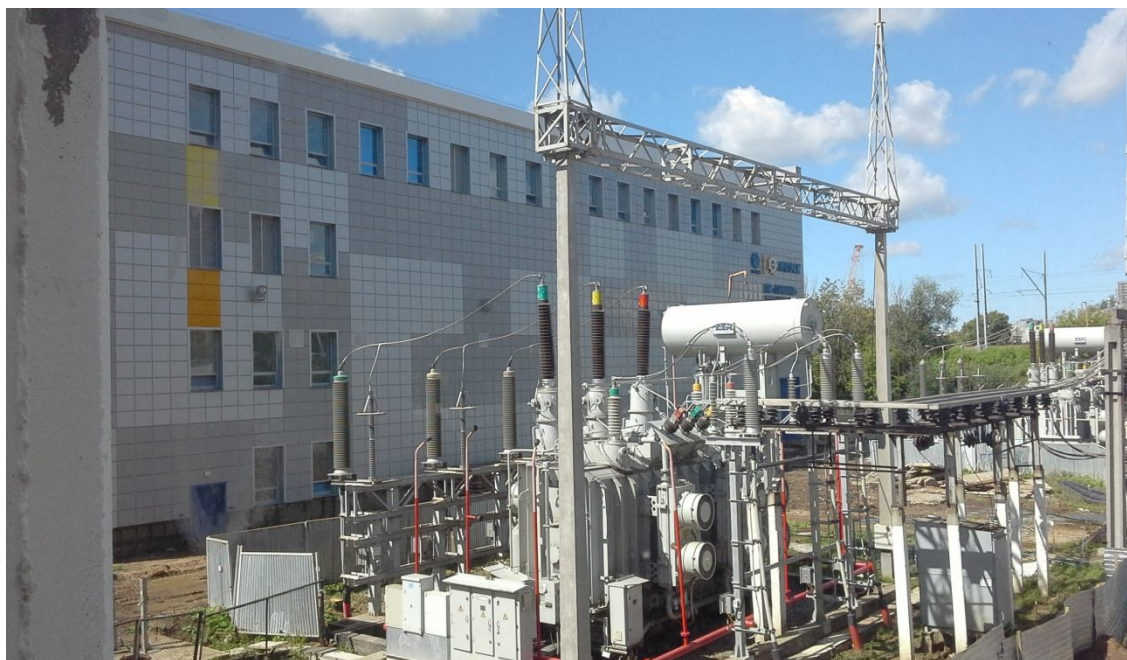
Рис. 6.4 Автотрансформатор 220/110/10 кВ мощностью 250 МВА
