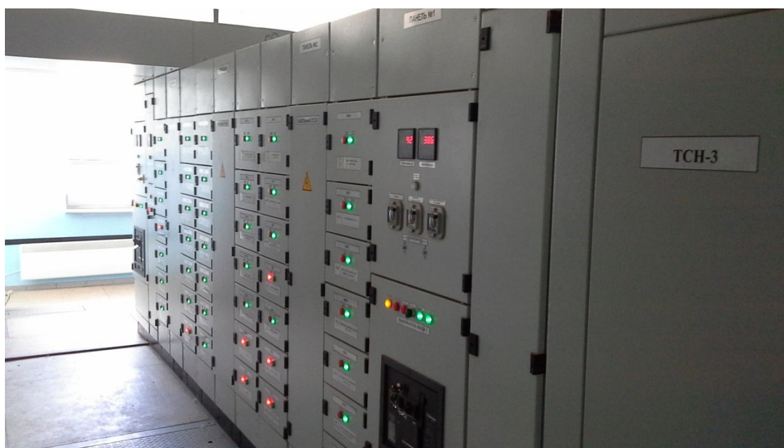
Рис. 6.5 Помещение щита собственных нужд
