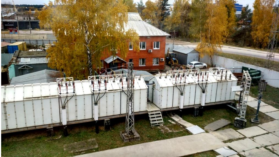
Рис. 6.2. КРУН 35 кВ в модульном здании
