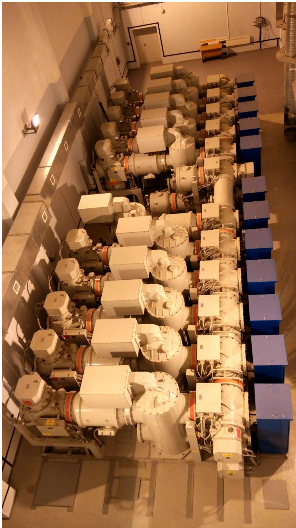
Рис. 6.3. Помещение КРУЭ 110 кВ
