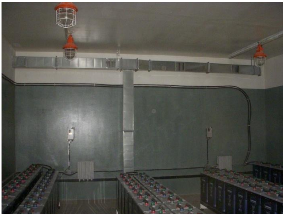
Рис. 6.8. Помещение Аккумуляторной батареи
