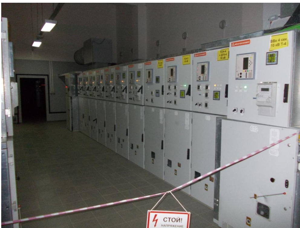
Рис. 6.5. Помещение КРУ 10 кВ.
