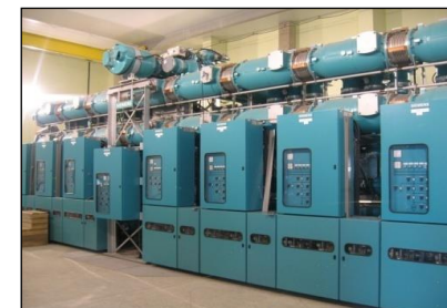
ПС 220/20/10 «Ильинская» ОАО «Энергоцентр»
