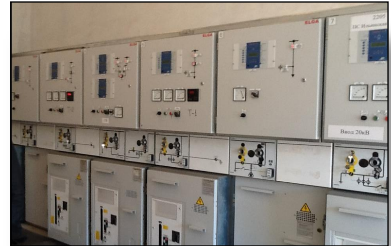
Оборудование РТП 20/10 кВ ООО «НЭТ»
