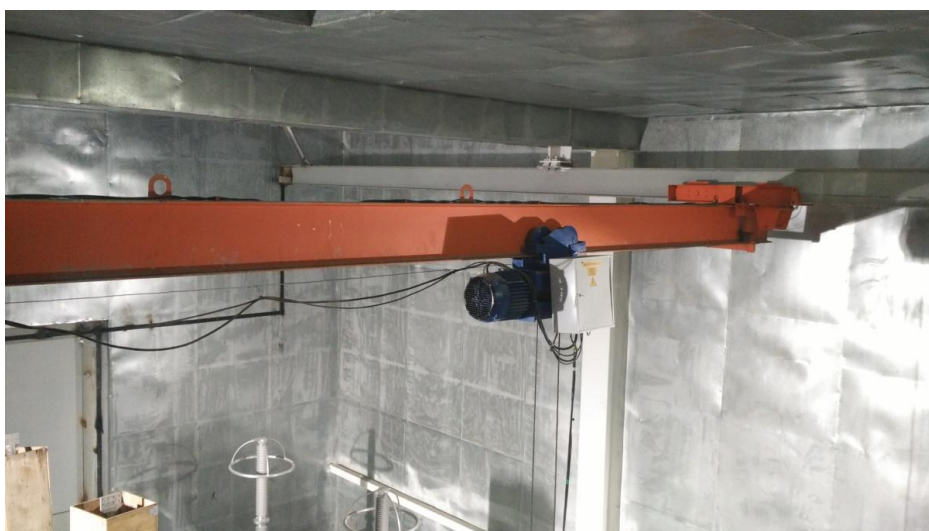
Рис. 6.13 Кран-балка в камере трансформатора.
