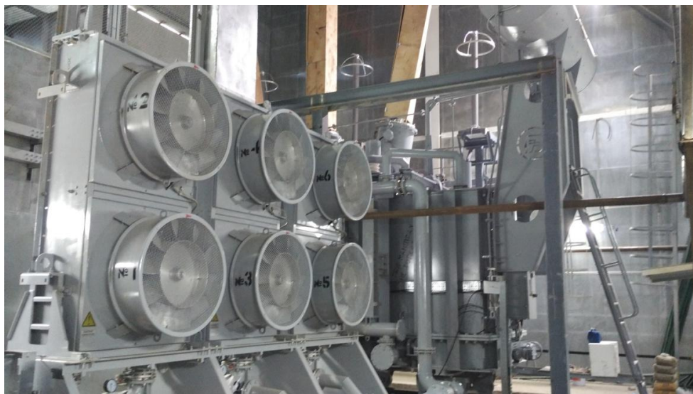
Рис. 6.4. Трансформатор ТРДЦН-80000/220-У1 с выносной системой охлаждения.
