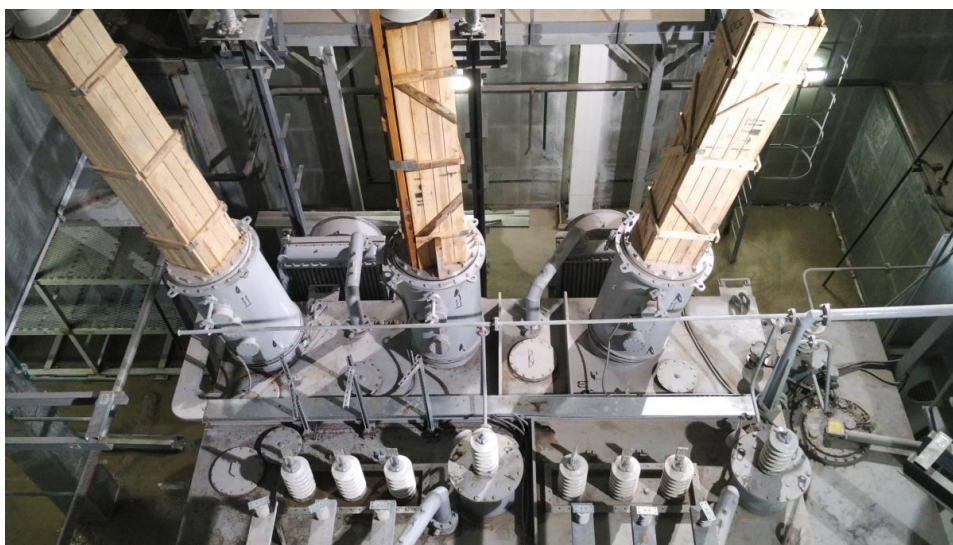
Рис. 6.3. Камера трансформатора ТРДЦН-100000/220-У1.
