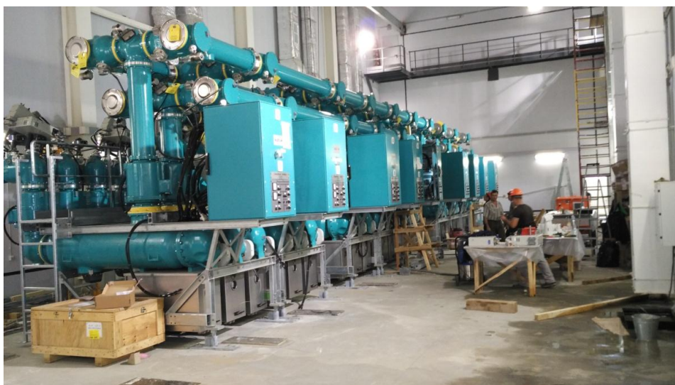
Рис. 6.2. Смонтированные ячейки КРУЭ 220 кВ, производства Alstom.
