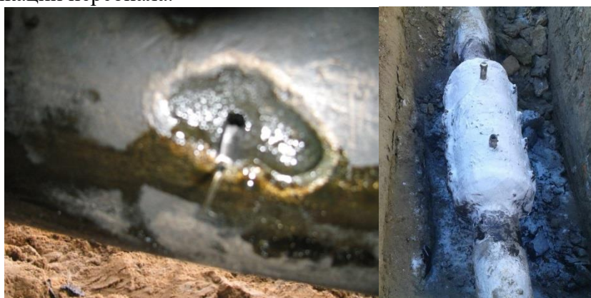
Рис. 1. Повреждение трубопровода и заморозка кабельной линии жидким азотом
