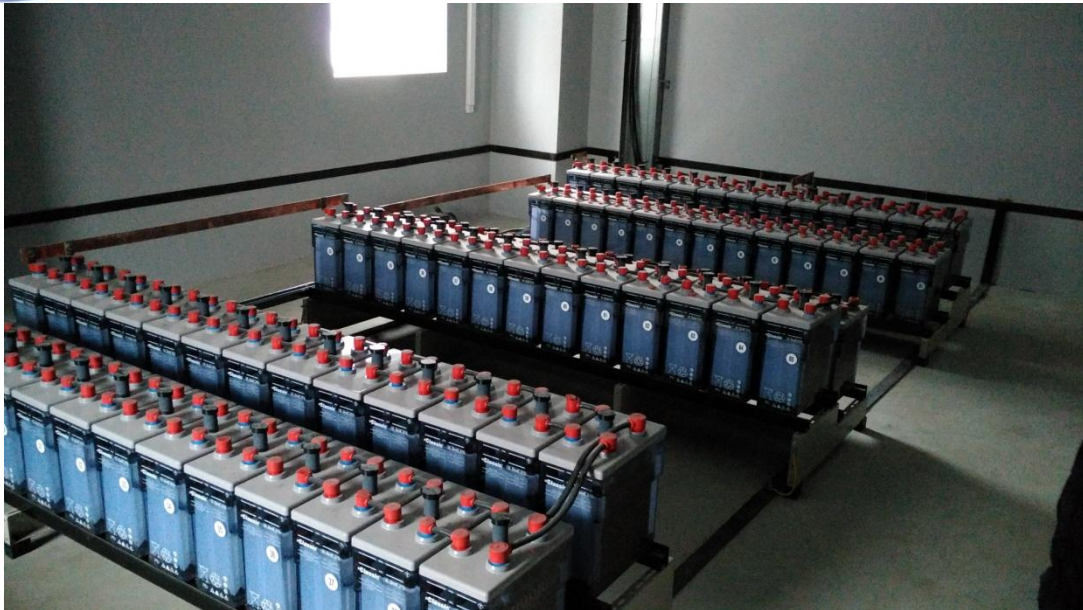
Рис. 6.7. Помещение Аккумуляторных батарей
