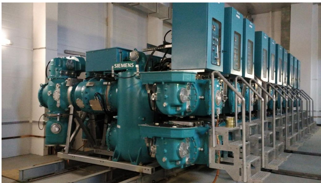
Рис. 6.2. Смонтированные ячейки КРУЭ 110 кВ
