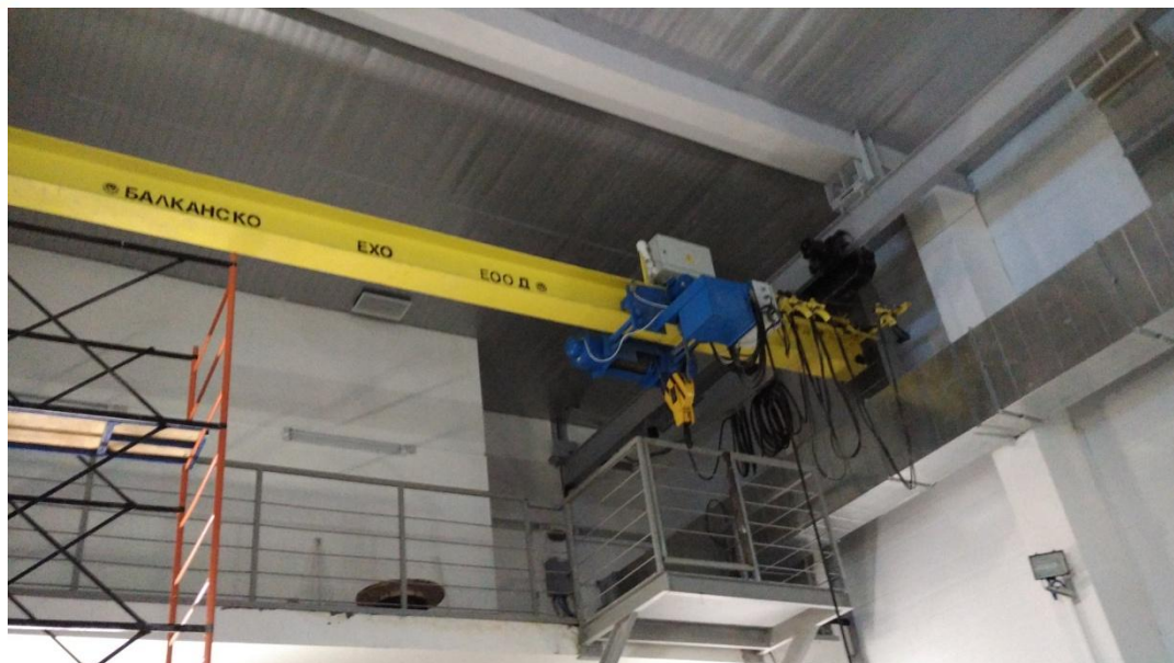
Рис. 6.4. Грузоподъемное оборудование с площадкой обслуживания в зале КРУЭ 110 кВ
