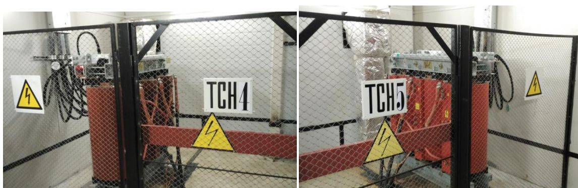
Рис. 6.6. Трансформаторы собственных нужд
