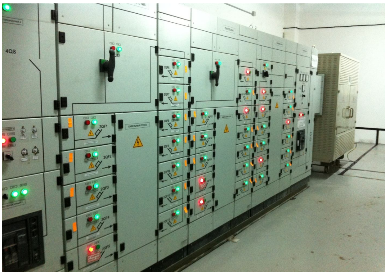
Рис. 6.6. Помещение КРУ 10 кВ
