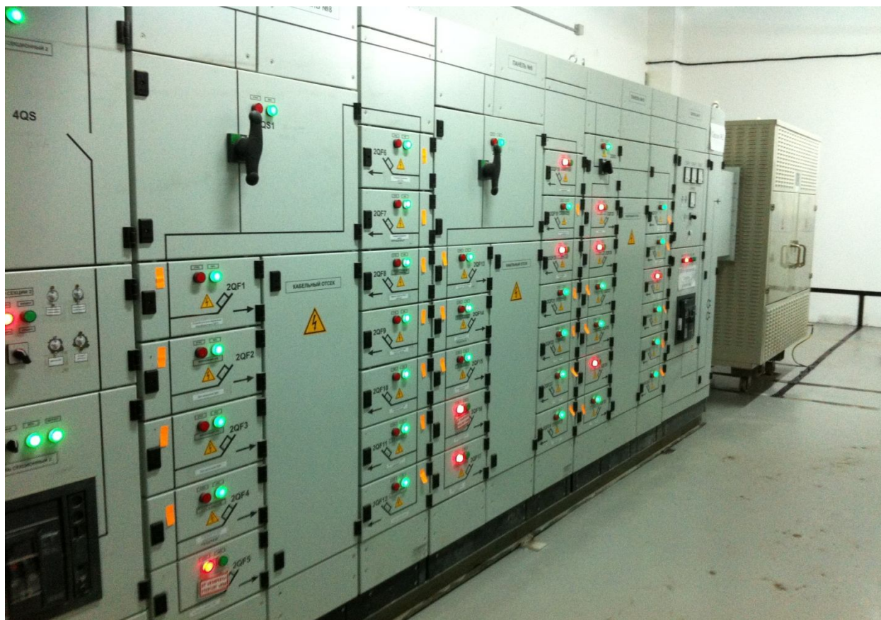
Рис. 6.6. Помещение КРУ 10 кВ
