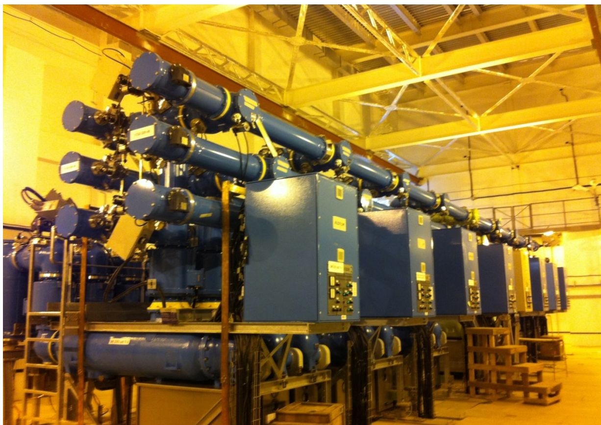
Рис. 6.3. Помещение КРУЭ 220 кВ.
