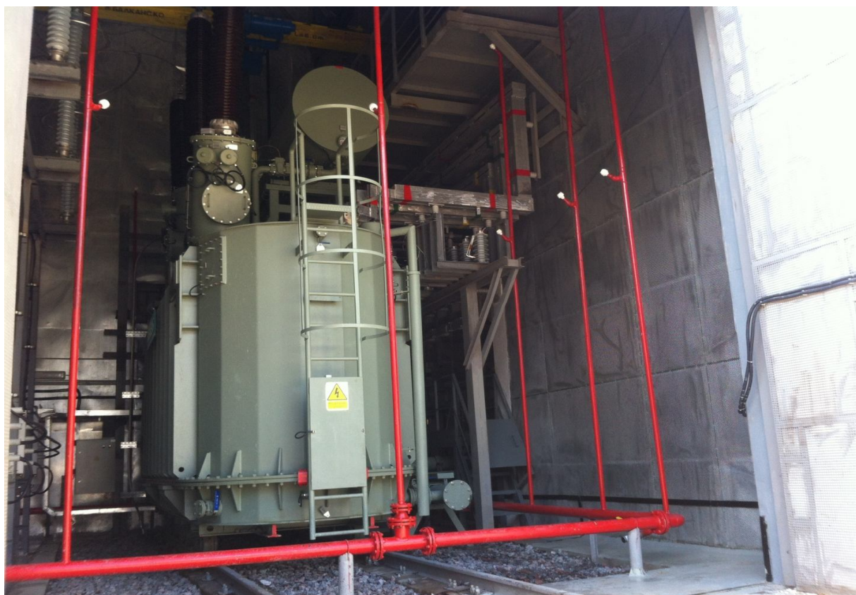
Рис. 6.4. Камера трансформатора 220/20/10 кВ мощностью 200 МВА
