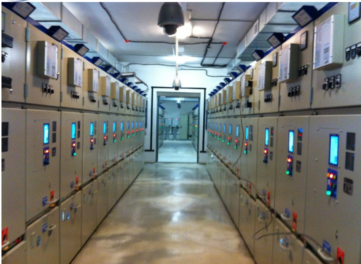
Рис. 6.6. Помещение КРУ 20 кВ.
