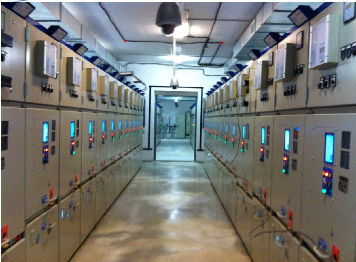
Рис. 6.6. Помещение КРУ 20 кВ.
