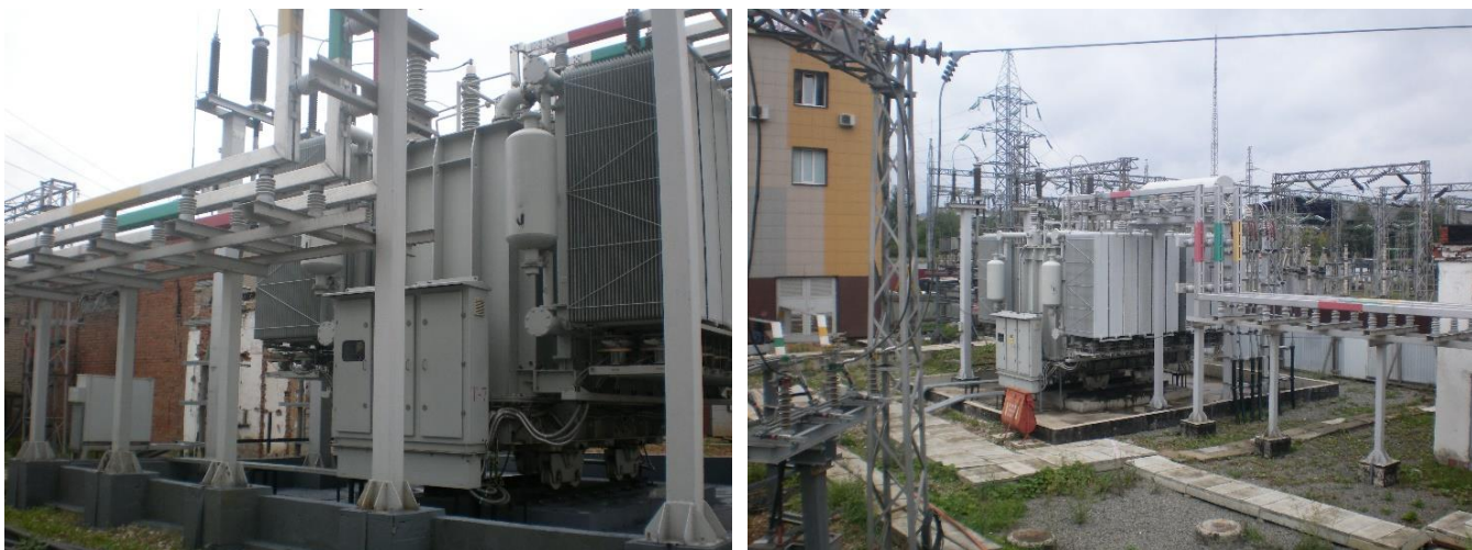
Рисунок 8 – Открытая установка трансформаторов Т-6 (Т-7) 80 МВА 110/35/6 кВ
