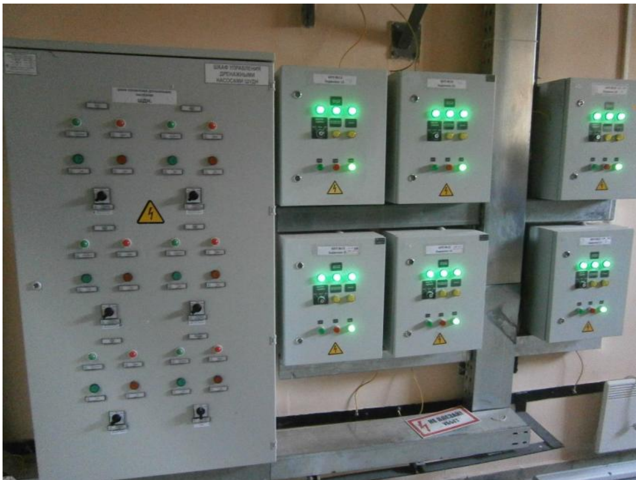
Рисунок 4 – Шкаф управления дренажными насосами и станция пожаротушения
