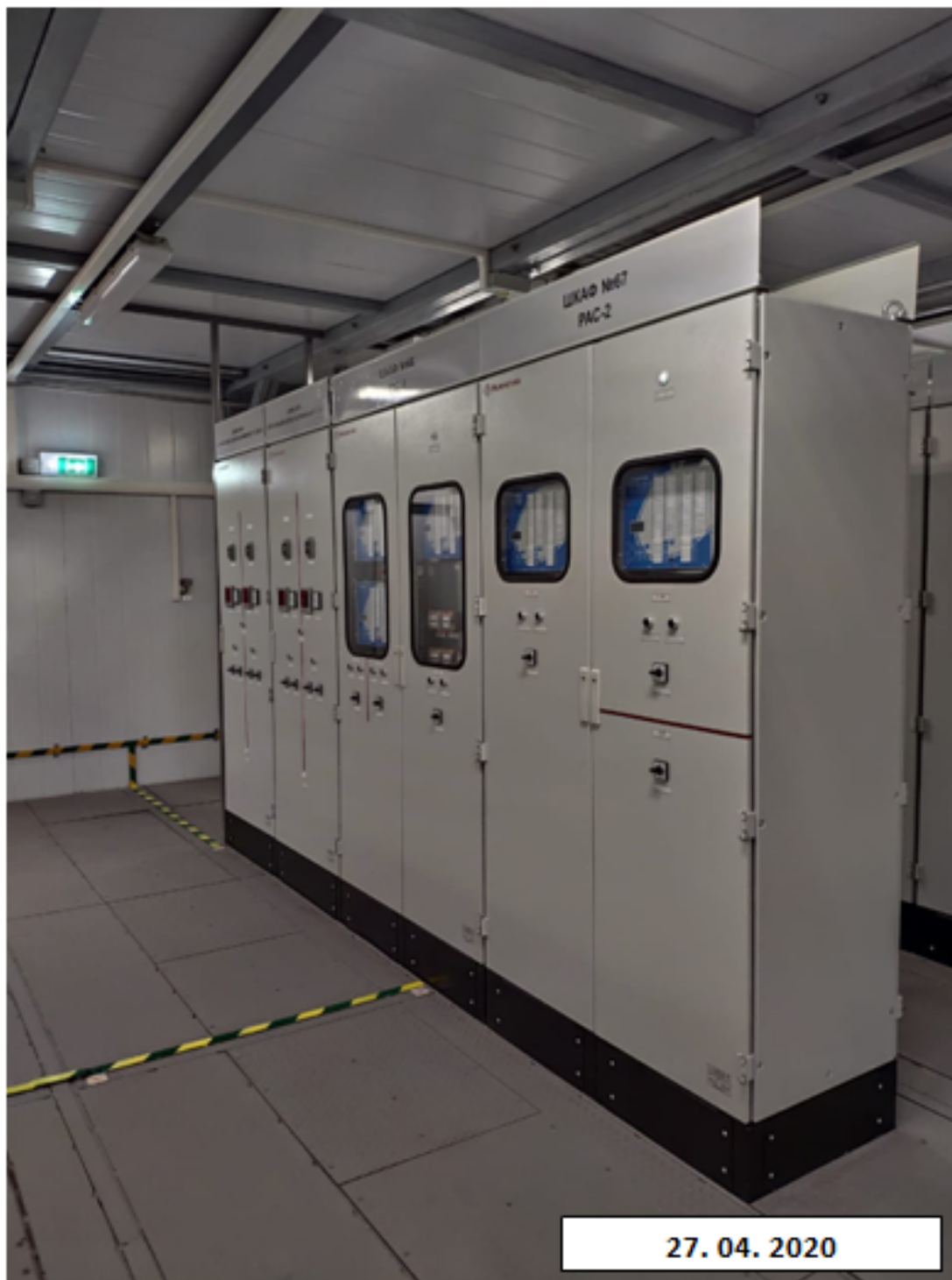
Помещение панелей РЗА, АРМ, АИИСКУЭ, АСУТП, СДТУ
