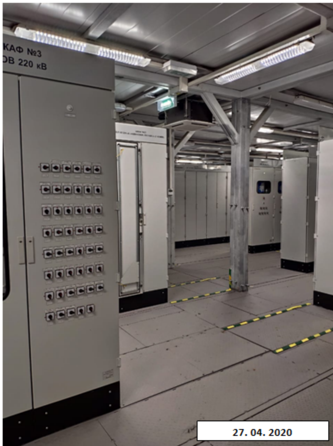
Помещение панелей РЗА, АРМ, АИИСКУЭ, АСУТП, СДТУ
