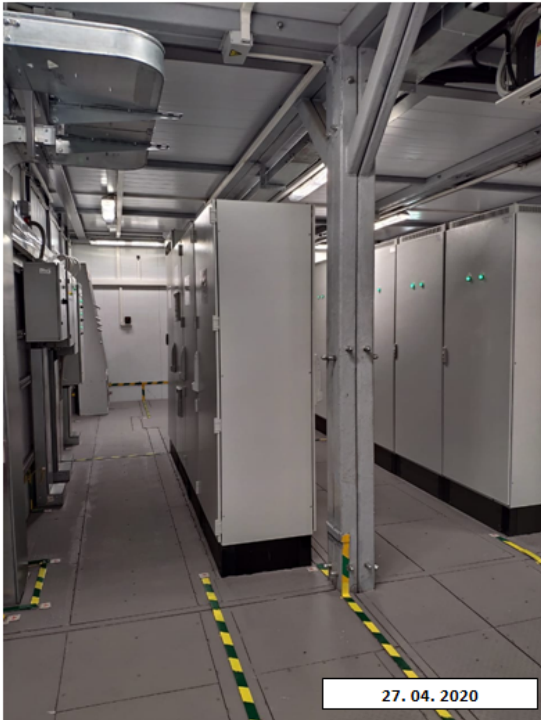
Помещение панелей РЗА, АРМ, АИИСКУЭ, АСУТП, СДТУ
