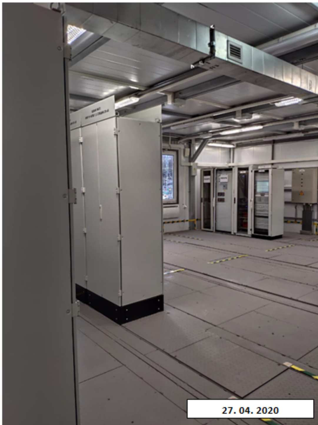
Помещение панелей РЗА, АРМ, АИИСКУЭ, АСУТП, СДТУ
