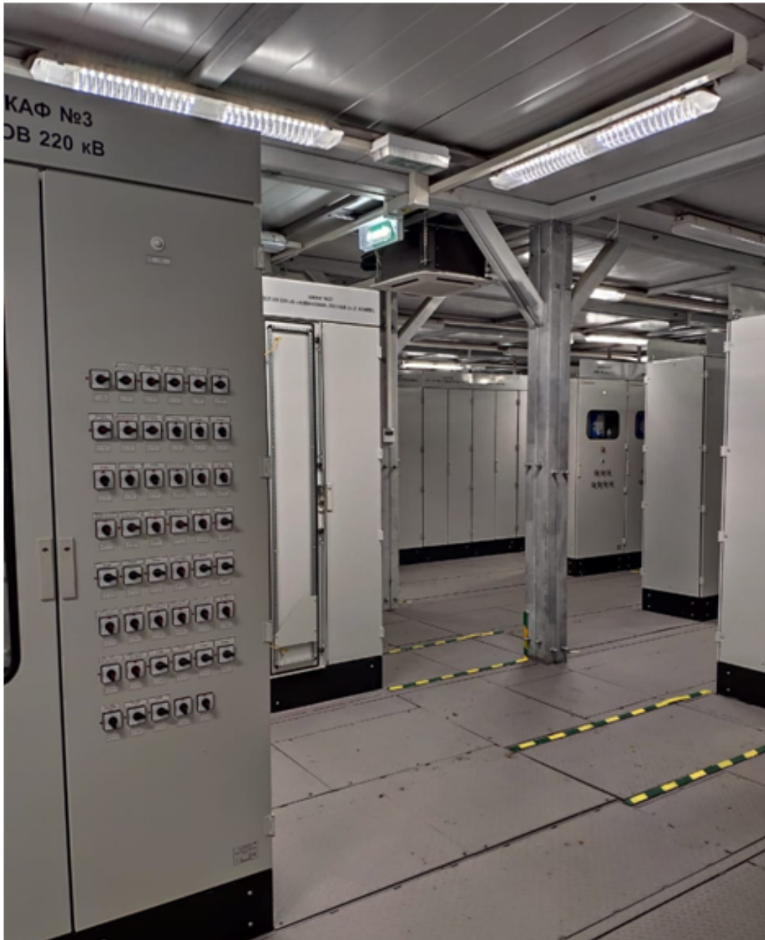
Помещение панелей РЗА, АРМ, АИИСКУЭ, АСУТП, СДТУ
