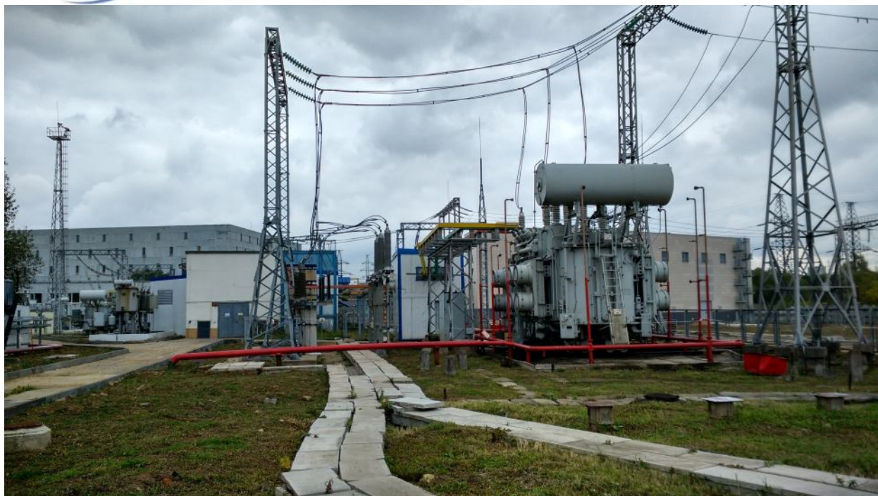
Рисунок 6-22. Автотрансформатор АТ-1 с ошиновкой 110 кВ.
