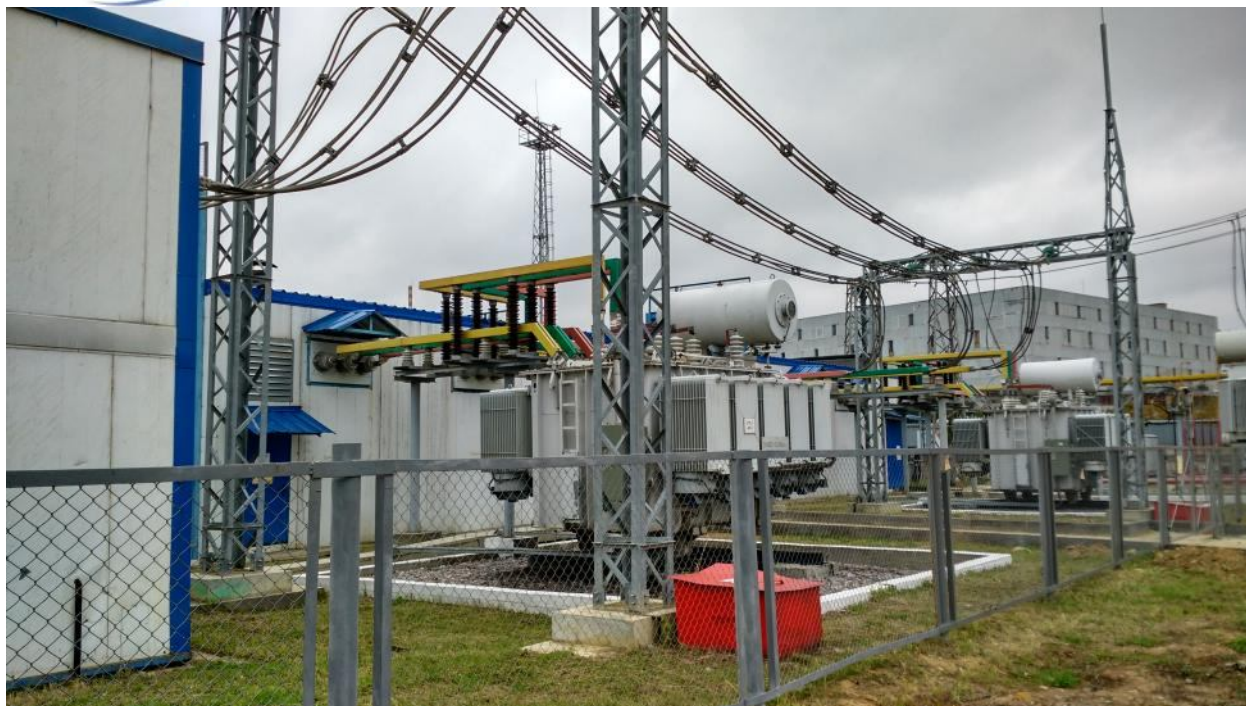
Рисунок 6-20. Регулировочный трансформатор РТ-1 и ошиновка 10 кВ.
