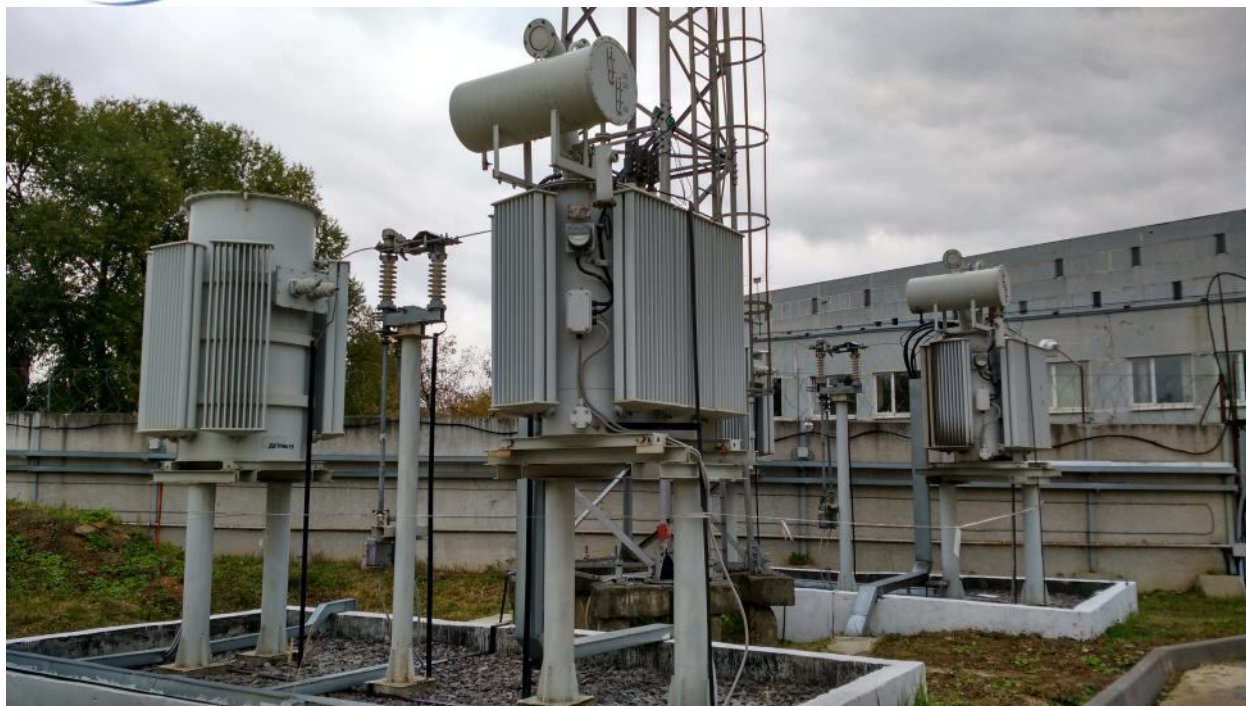
Рисунок 6-24. Дугогасящий реактор 10 кВ с разъединителем и трансформатором.
