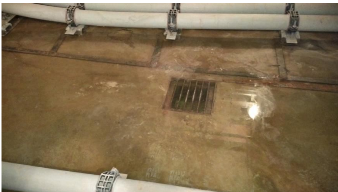
Рисунок 6-2. Частичное подтопление кабельного этажа здания КРУЭ.
