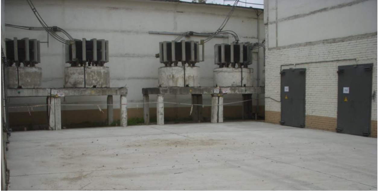
Рисунок 6-26. Существующие бетонные реакторы 10 кВ и камера трансформатора 110/10 кВ Т-3.
