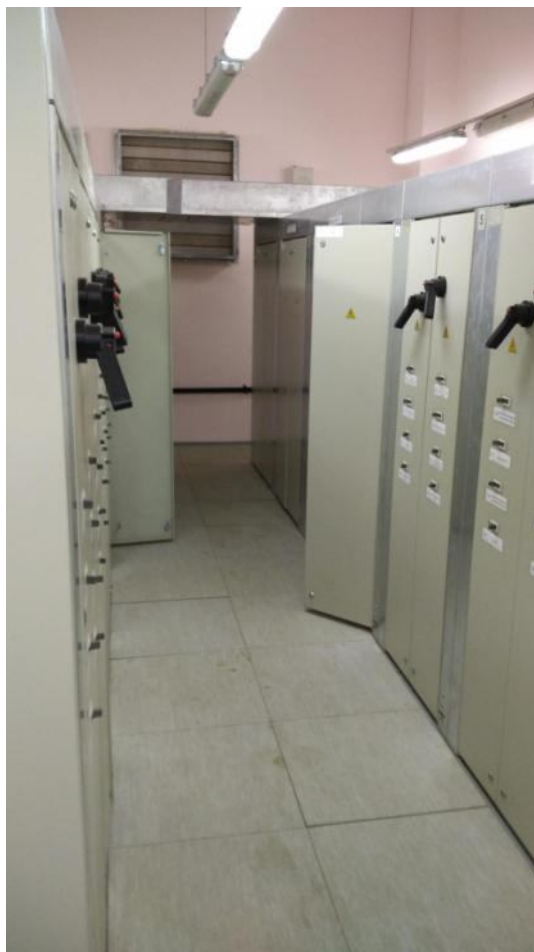
Рисунок 6-9. Щит собственных нужд 0,4 кВ здания КРУЭ.
