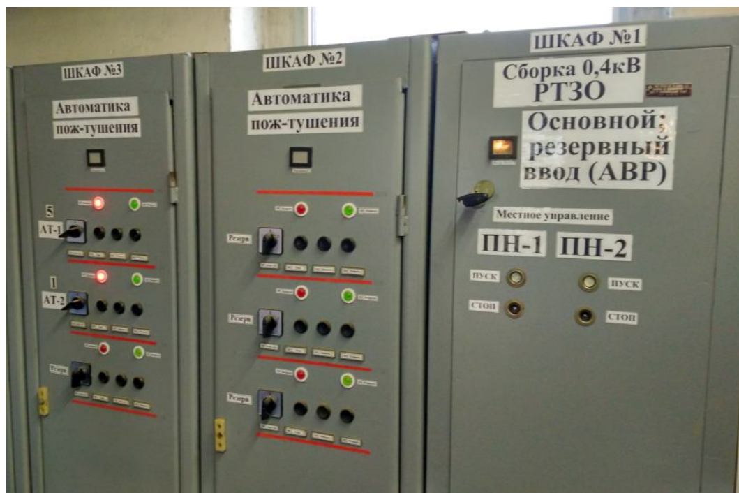
Рисунок 6-25. Щит автоматики пожаротушения в здании пожарной насосной.
