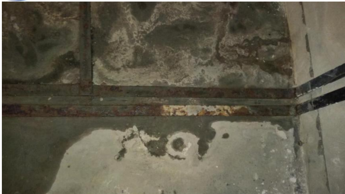
Рисунок 6-3. Коррозия проводников системы уравнивания потенциалов.
