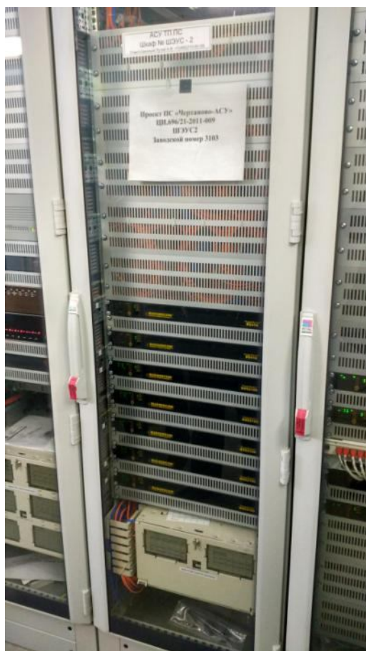
Рисунок 6-11. Шкафы АСУ ТП ЭЧ.
