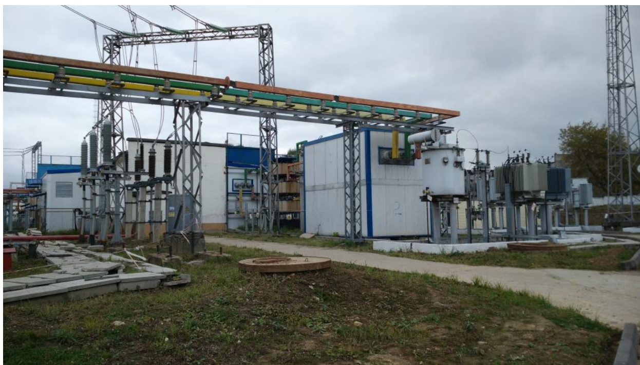
Рисунок 6-21. Блочное здание разъединителей 10 кВ. ДГР 10 кВ с трансформатором.
