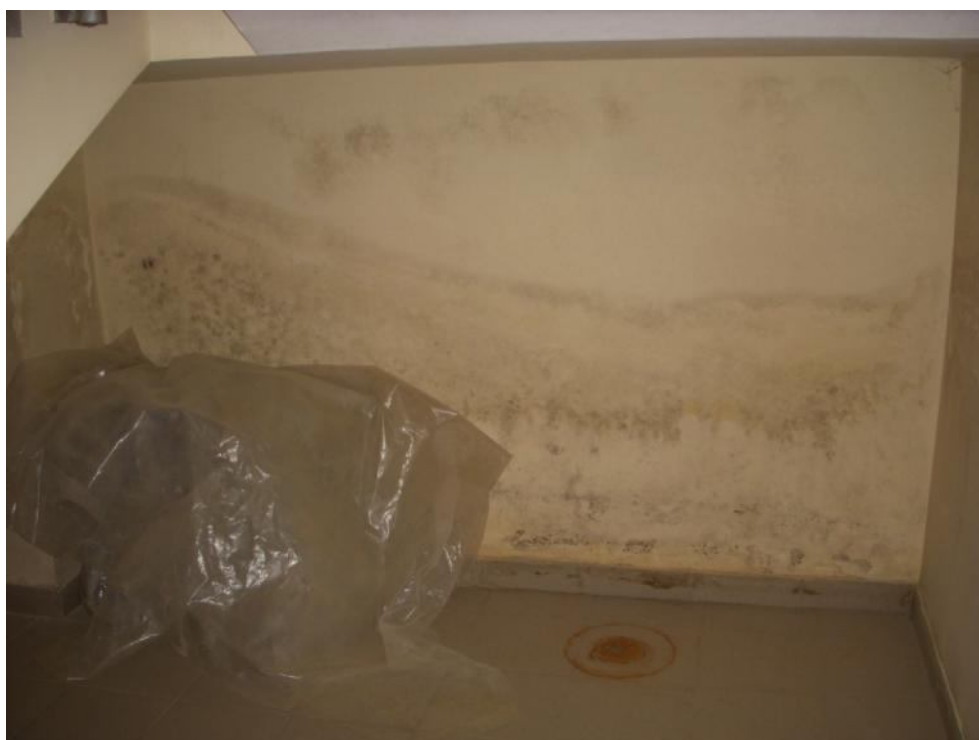
Рисунок 6-4. Грибок на стенах кабельного этажа КРУЭ.
